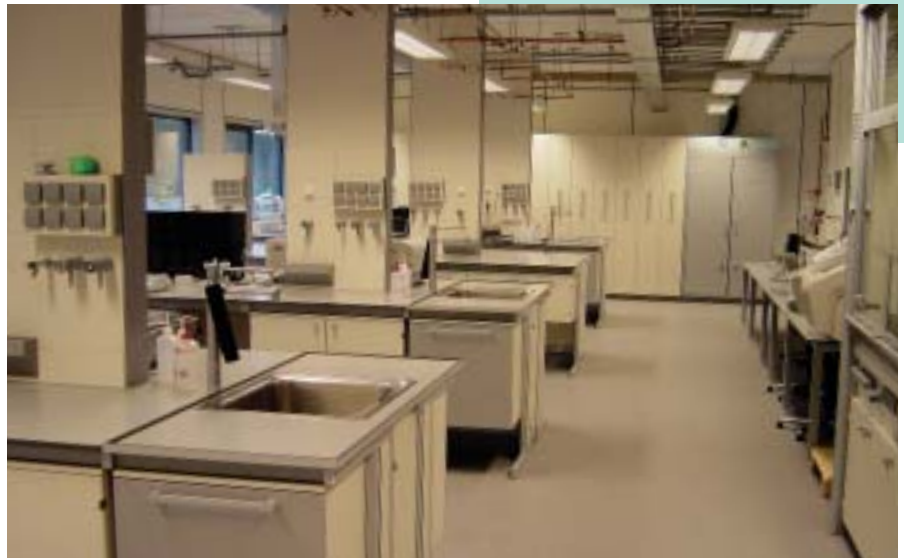
Vast meubilair in een standaardgebouwopzet. In de zuilen zijn de medialeidingen en appendages aangebracht. (Foto: Waldner Benelux bv)
